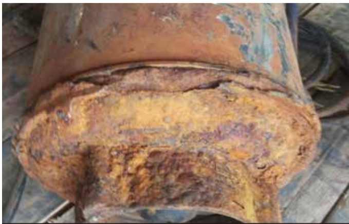
未加裝陽極片，泵浦使用五個月後，被海水嚴重侵蝕框架與罩殼。
